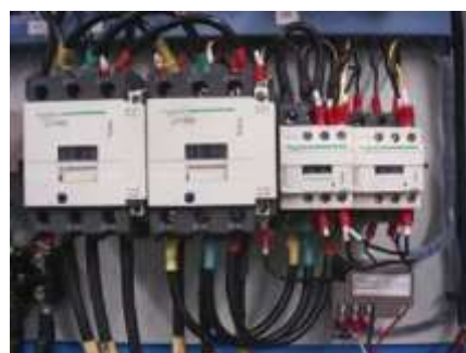
Рис. 8. Концы входного провода электропитания
